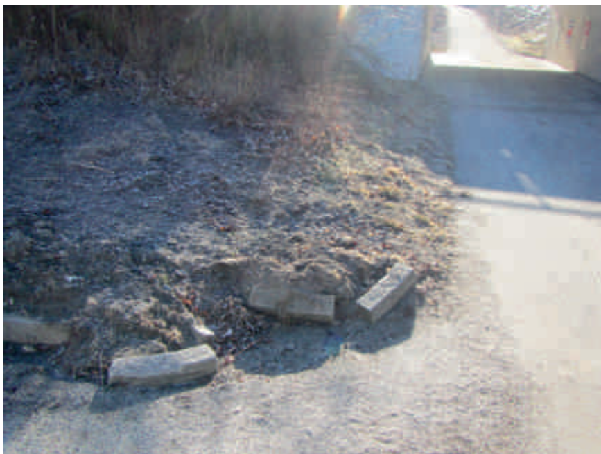
En vanlig plogskada i samband med övertagandebesiktning i en kommunal vinterdriftsentreprenad. Foto: Peter Sandberg.
