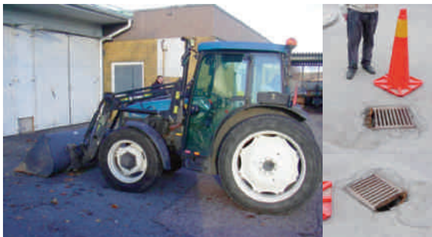
En typisk vardagsrisk i vinterväghållning. Brunnen kördes sönder vid isskrapning med frontmonterad skopa. Foto: Claes-Anders Malmberg
