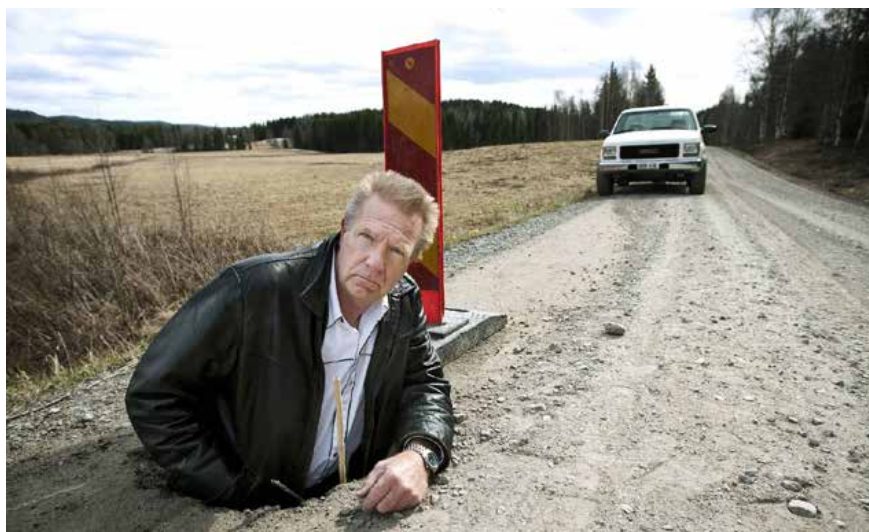
Hålrum uppstår i väggroppen när materialet i vägbanan sjunker på grund av att väggroppen har tinat upp och mist sin höga frusna bärighet. Foto: Jennie Johansson.
