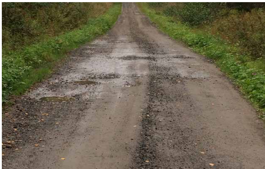
Stående vatten på körbanan. Foto: Ulrika Appelberg.
