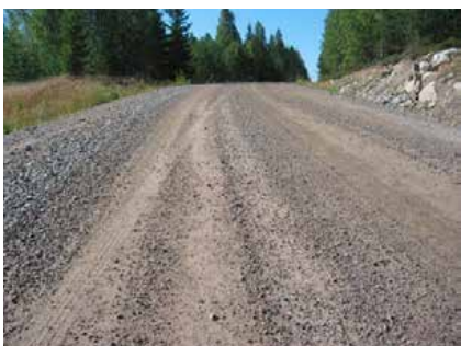
Tillståndsvärde 3. Löst grus förekommer på vägbanan och i mindre vallar längs vägkanterna, vilket inverkar på körkomforten och säkerheten i väsentlig grad.
