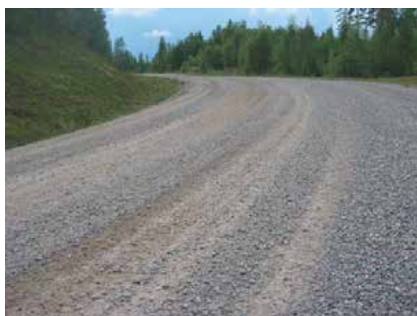
Tillståndsvärde 4. Löst grus förekommer i stor omfattning över hela vägbanan och i utpräglade vallar längs vägkanterna, vilket inverkar på körkomforten och säkerheten i mycket väsentlig grad.
