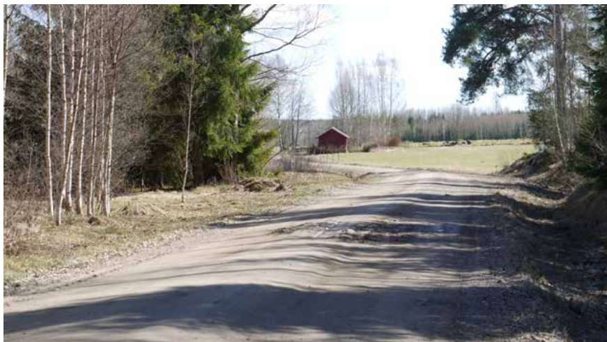
Vid tjällossning frigörs vatten i övre lagren samtidigt som underliggande material är fruset. Detta skapar spårig vägbana med förlorad bärighet. Foto: Karin Edvardsson.
