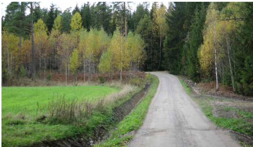
Felaktigt utförd nydikning. Växtligheten på vägrenarna och innerslänterna har inte tagits bort. På bilden syns också sättningar över en vägtrumma. Foto Leif Kronkvist, Riksförbundet Enskilda Vägar.
